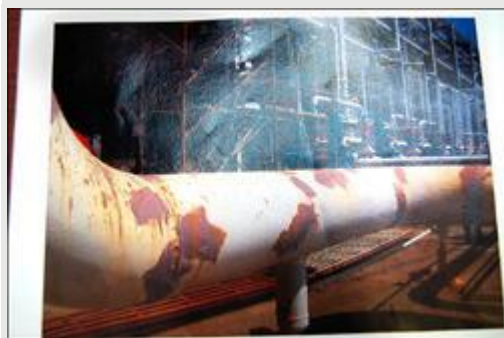
台塑六輕曾被環保署監測到排氣管鏽蝕。（陳重信提供）
